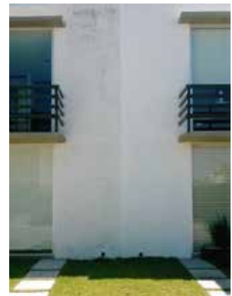
Otras marcas VS Euro Paint despues de 6 meses de aplicación
